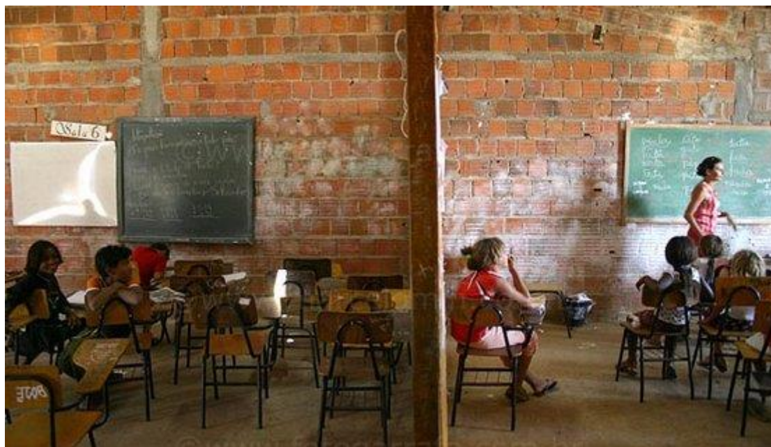
Figura 3: Escola do Campo em estado precário. | Fonte:
